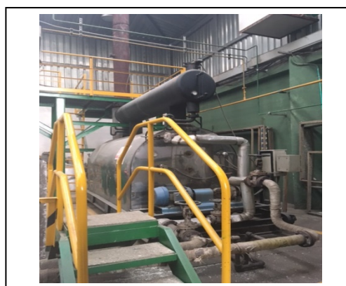
FOTOGRAFIA 2. CALDERA DE 80 BHP
