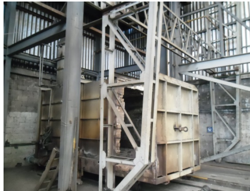
Foto 6. Horno de tratamiento térmico.
