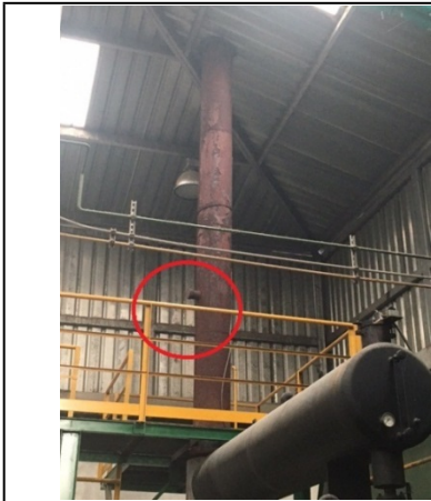
FOTOGRAFIA 3. DUCTO DE LA CALDERA
