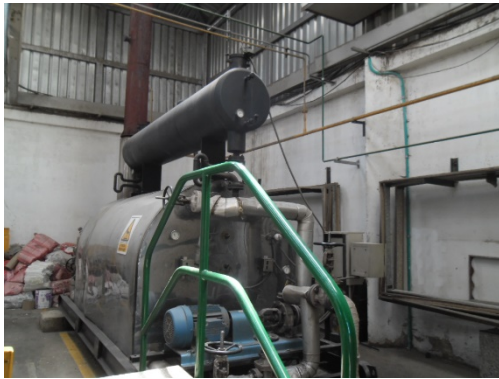
Foto 1. Caldera de 80BHP.
